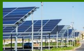
Ombrières de parking
